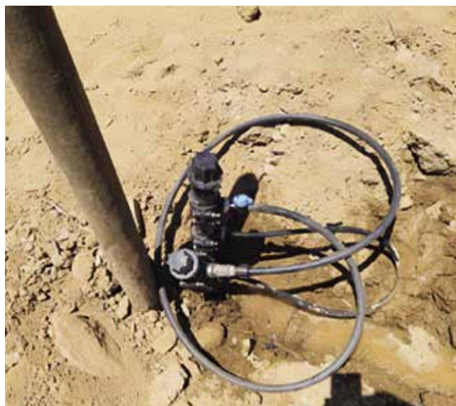
Regulação de caudal à entrada no setor
